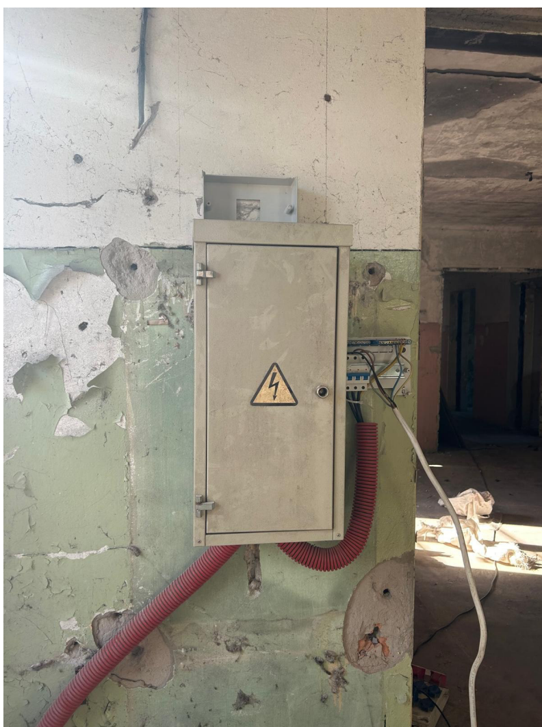
8.1.1.att. Sadales kaste Talsu ielā 3A
